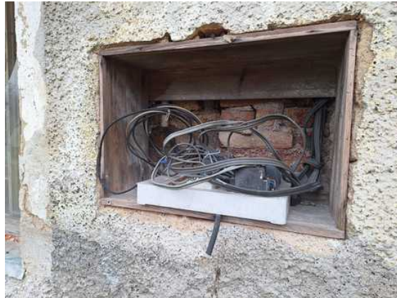
- stavba bez čp/če na p.č.st.304 - rozvody elektroinstalace
